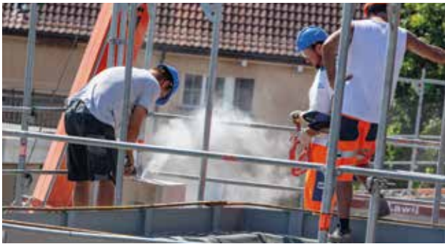
An Ort und Stelle werden noch einzelne Passstücke auf die richtige Grösse zugeschnitten ...
